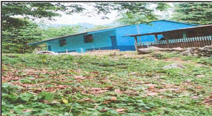
Foto 3: Así se quedo la escuela grande.
